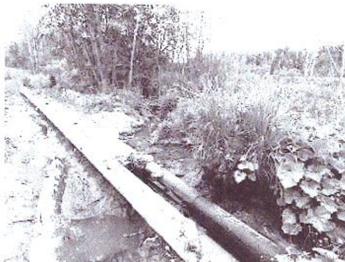
Рисунок 8. - Аварийное состояние напорного коллектора
