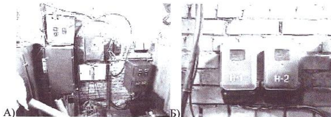
Рисунок 10. - КНС №2: а) Электрооборудование, б) Узел учета эл.
