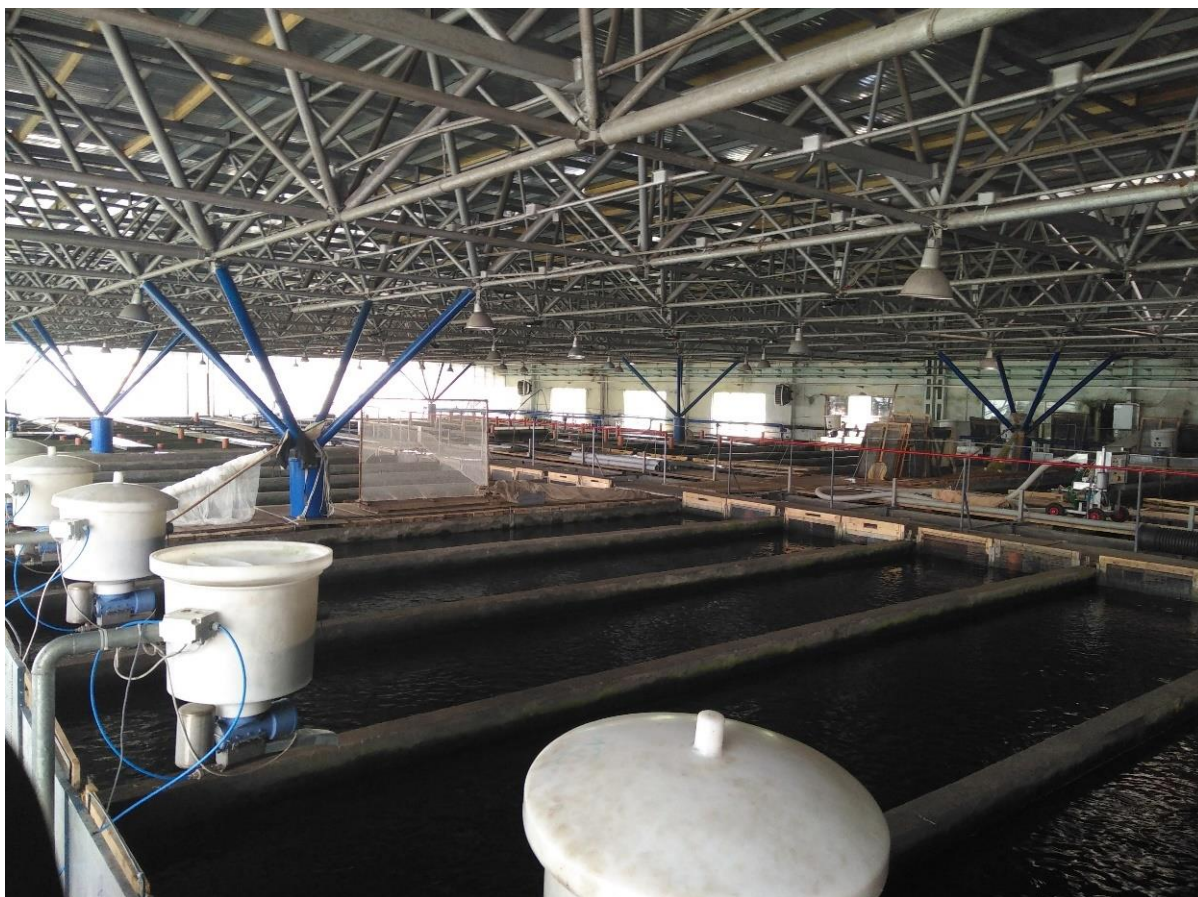
Рис. 16. Бетонные каналы модуля УЗВ в павильоне №2. Фото из архива автора.
