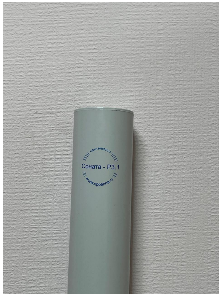
Рисунок 14 – Установленная «Соната-РЗ.1» в помещении № 2156
