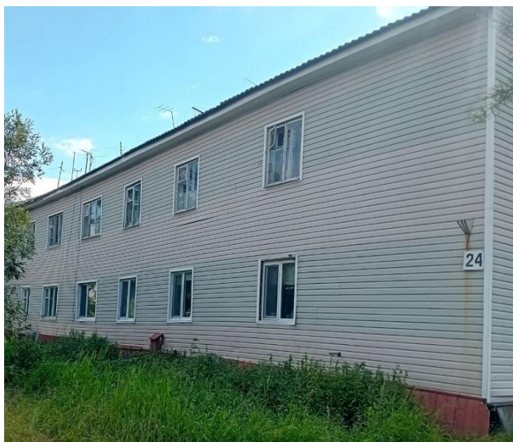
Рис. 6. Пример деформации здания, расположенного по адресу ул. Мира, 24 (год постройки: 1972, аварийное состояние; личный архив, дата съёмки: 15 августа 2024 г.)
