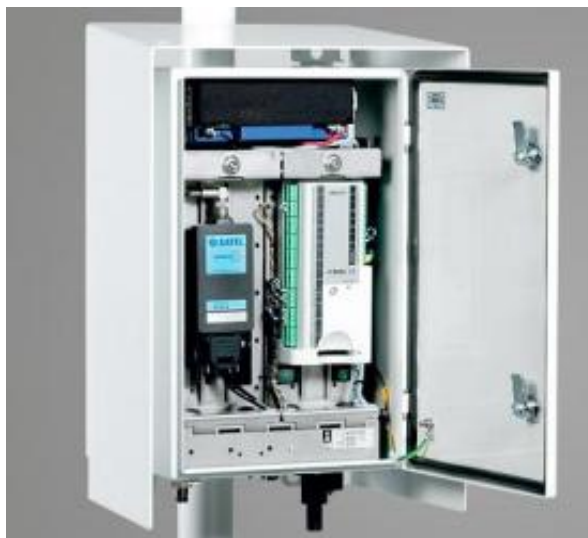
Рисунок 2.3.2. Аппаратурный шкаф АДМС
