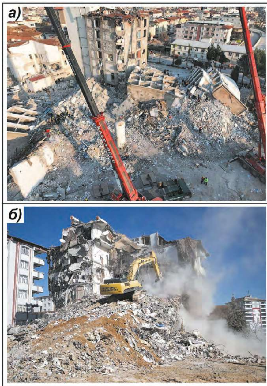
Рис. 6.9. Последствия землетрясения в Турции 6 февраля 2023 г.: а) провинция Хатай; б) г. Газиантеп.
